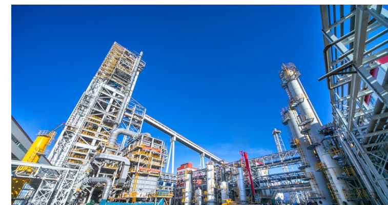
12月16日，河钢全球首例120万吨氢冶金示范工程一期全线贯通
